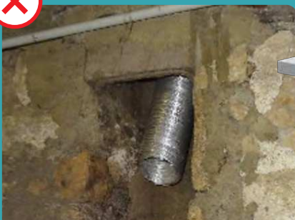
Prise d'air de la cheminée provenant de la cave
