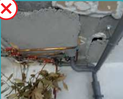
Passage de réseau du sous-sol au RDC
