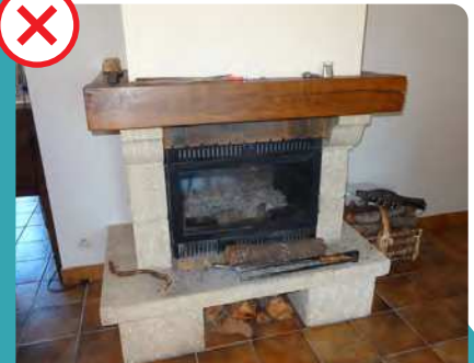
Cheminée sans entrée d'air dédiée
