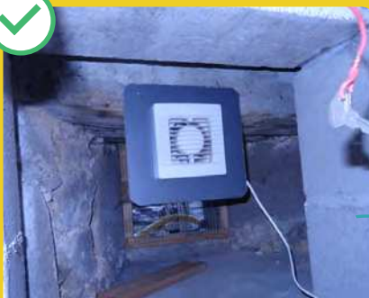
Extracteur électrique sur fenêtre du garage
