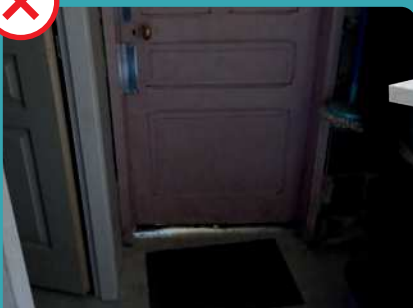
Porte de communication entre garage et cuisine trop détalonnée
